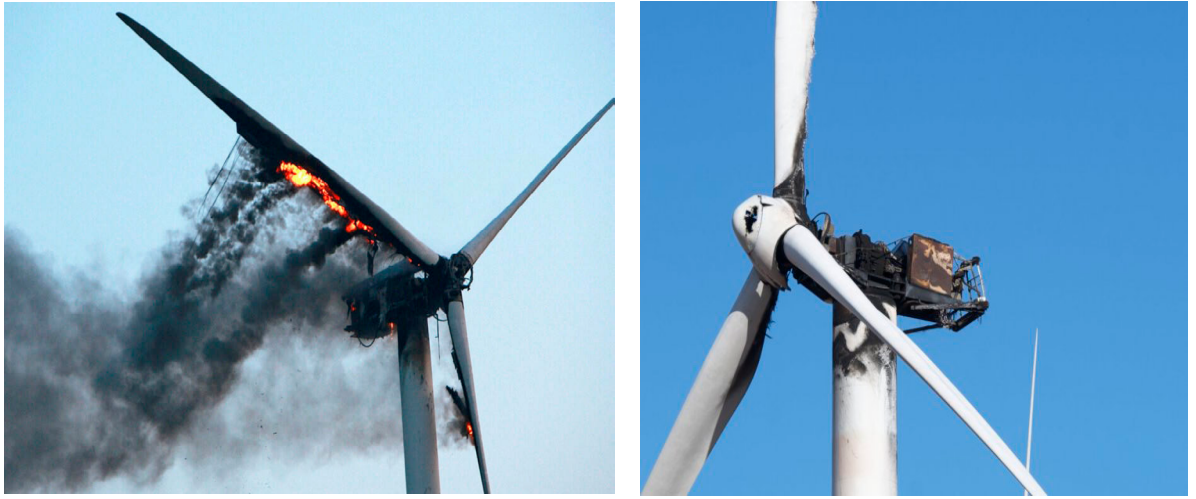
Şekil 3. Türbin arızası ve yangın (MECF, 2019; Simith, 2014)
