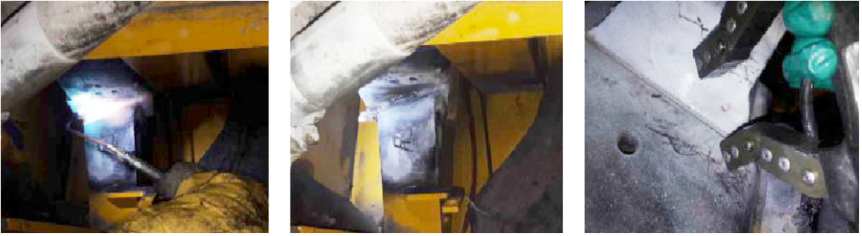
Resim 10. Bir tamir işleminde, oluşan çatlakın tamirasyonu ve tamirat sonrası kontrolü örneği
