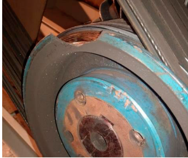
Şekil 15: VE-4 MEXA19 VS-1 LAK ekipmanına ait hasarlı kasnak
