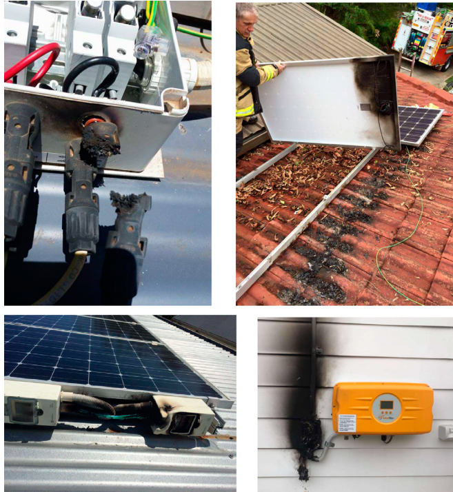
Şekil 3. DC arkın oluşturduğu yangın ve ekipman hasarı [3]
