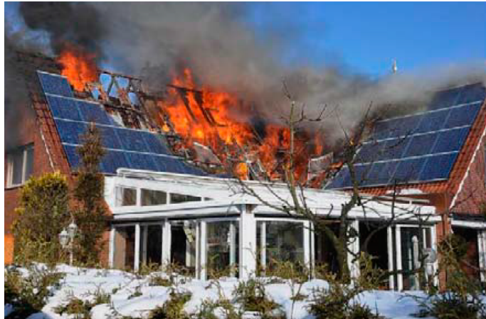
Şekil 8. Fotovoltaik santrallerde izolasyon hatası sonucu yangın oluşumu [6]
