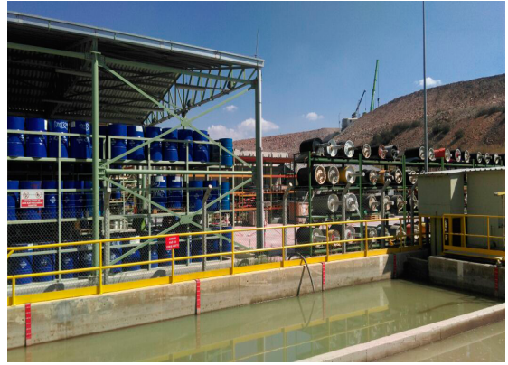
Resim 2. Yıkama Atık Su Toplama Havuzu
