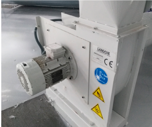
Şekil 2.1: Ölçümü yapılan fan
