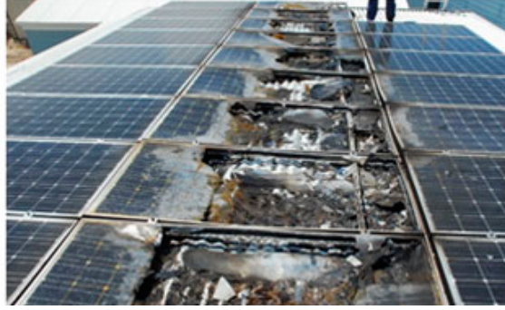
Şekil 1. Yıldırım deşarjına maruz kalmış bir fotovoltaik santral [1]
