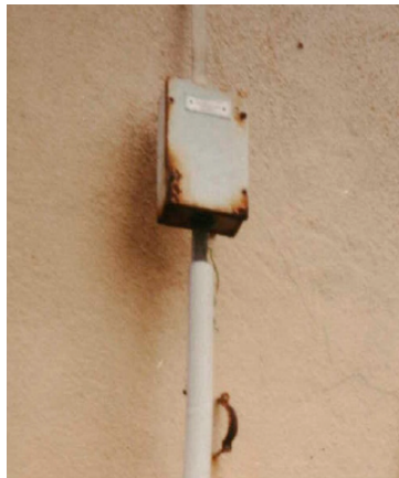
Şekil 9. Korozyona maruz kalmış bir iniş iletkeni [5]
